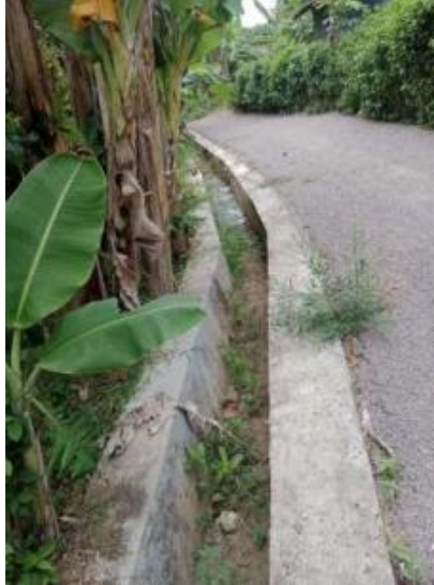
Gambar 7. kondisi selokan yang sudah ditumbuhi rerumputan.
