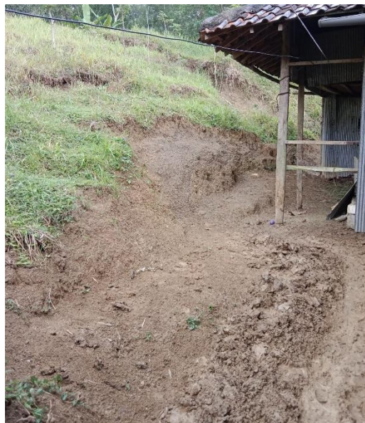
Gambar 1 Kondisi tanah Desa Kokop
